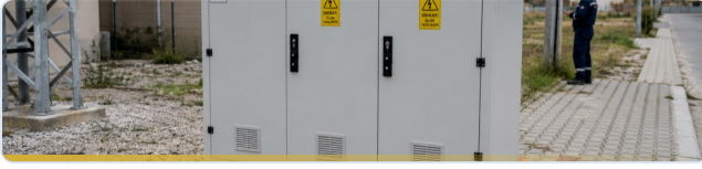
Harici Sac Dağıtım Panosu Outdoor Distribution Pillar
