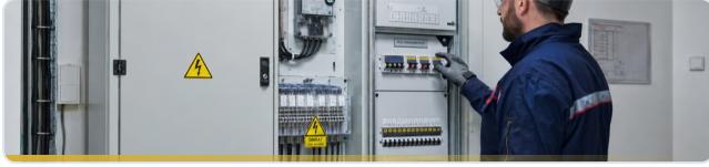
Sayaç / Ölçüm Panosu Metering Panel
